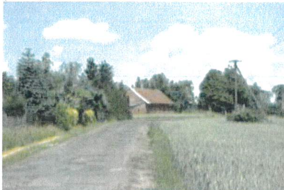
Przykład zniszczonej nawierzchni asfaltowej drogi gminnej w Broniszewie
