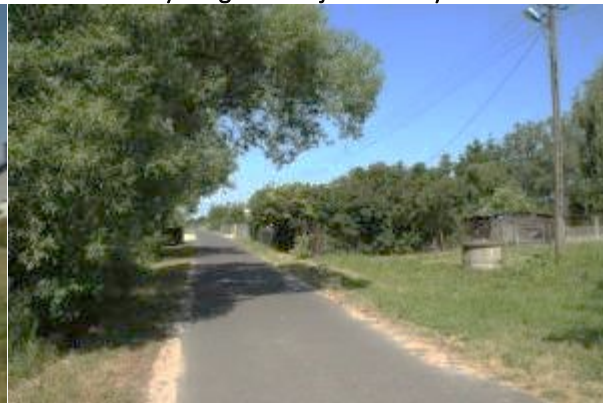
Stan techniczny drogi lokalnej w Nadarzycach
