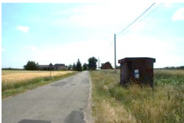
Nierówna nawierzchnia drogi prowadzącej do Noskowa
