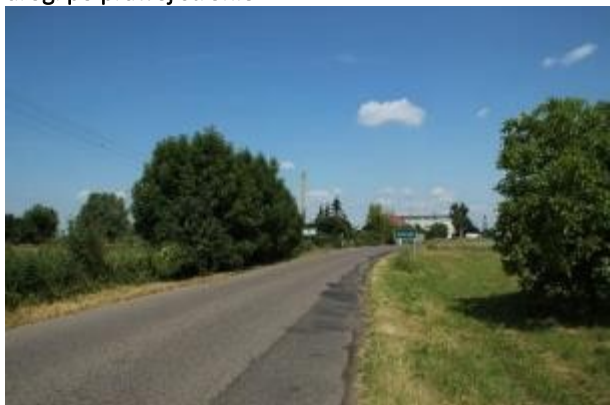
Wjazd do centrum Otocznej, spękana nawierzchnia drogi po prawej stronie
